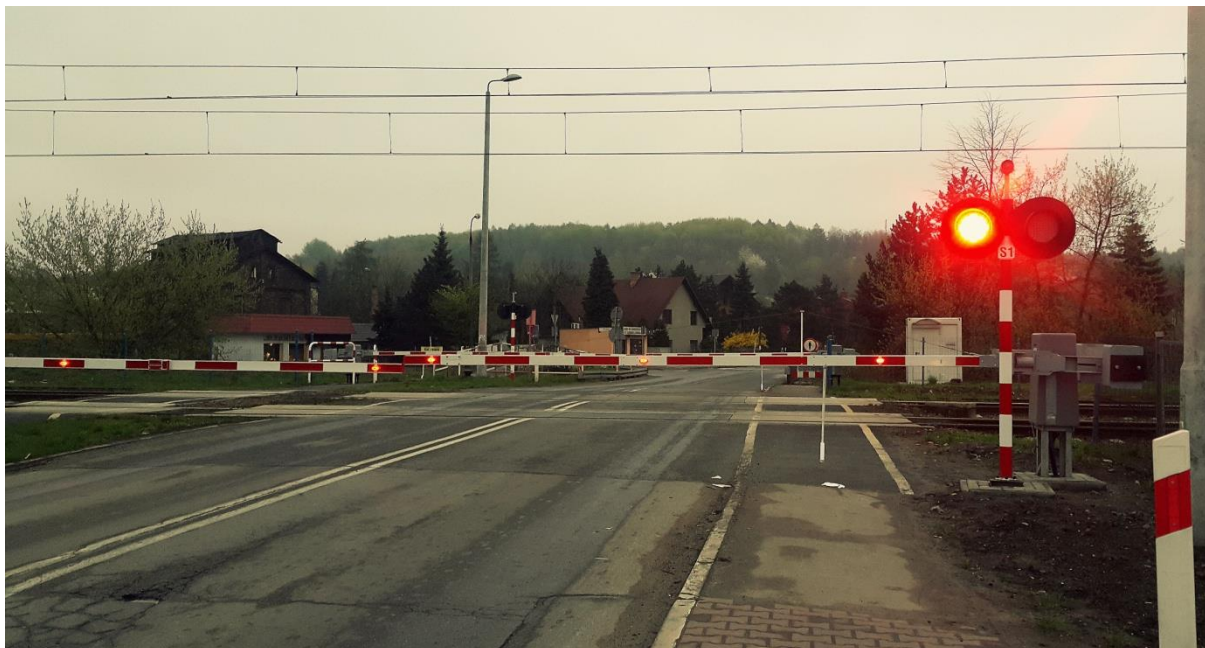
Rys. 5. Przejazd kolejowo-drogowy kat. A w Dąbrowie Górniczej Południowej na linii 133 z uzależnieniem położenia rogatek w drodze przebiegu
